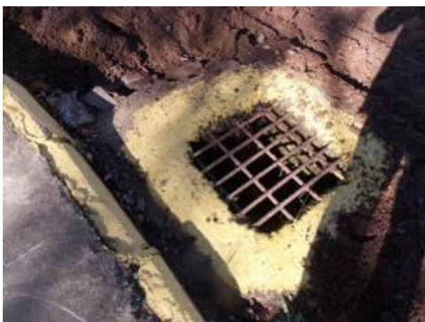
Imagem 12: Esquina das Ruas Francisco Guerino com José Pinton, mostra a sarjeta fora das especificações técnicas
